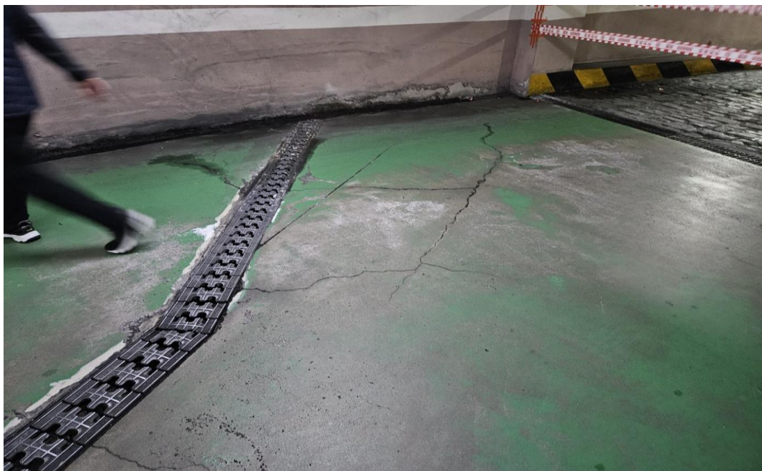
공사 전 (균열부위)
