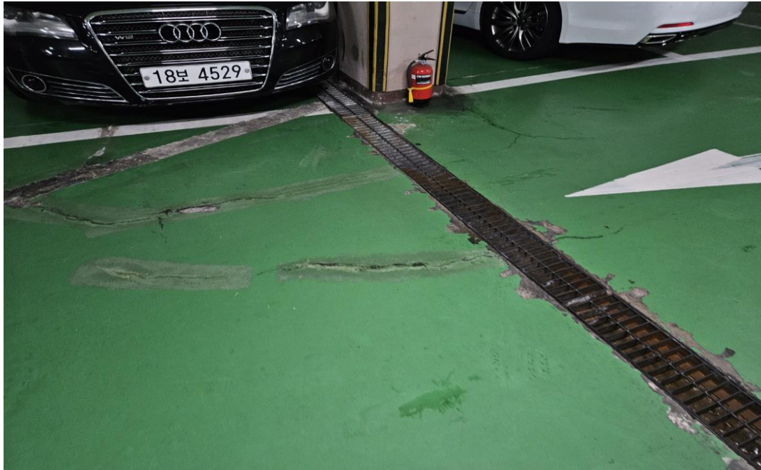
공사 전 (균열부위)
